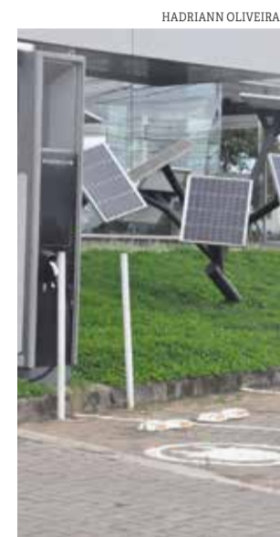
Ponto de recarga para carros elétricos, Porsche, Raja Gabaglia, Estoril
